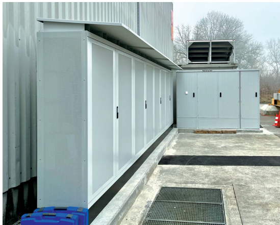
Strag Süd, Aussenkabinen für die 4 Wechselrichter und die Haupt- und Unterverteilung sowie der LWL-Schrank
